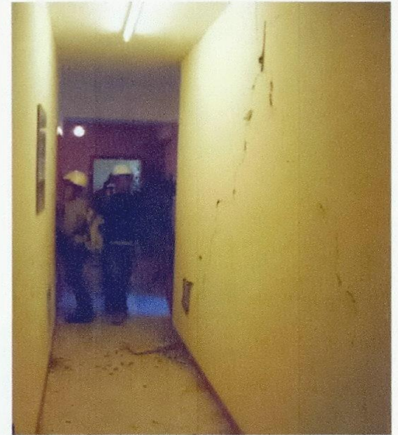
Stato Limite di Danno (Operational) (L'Aquila)
